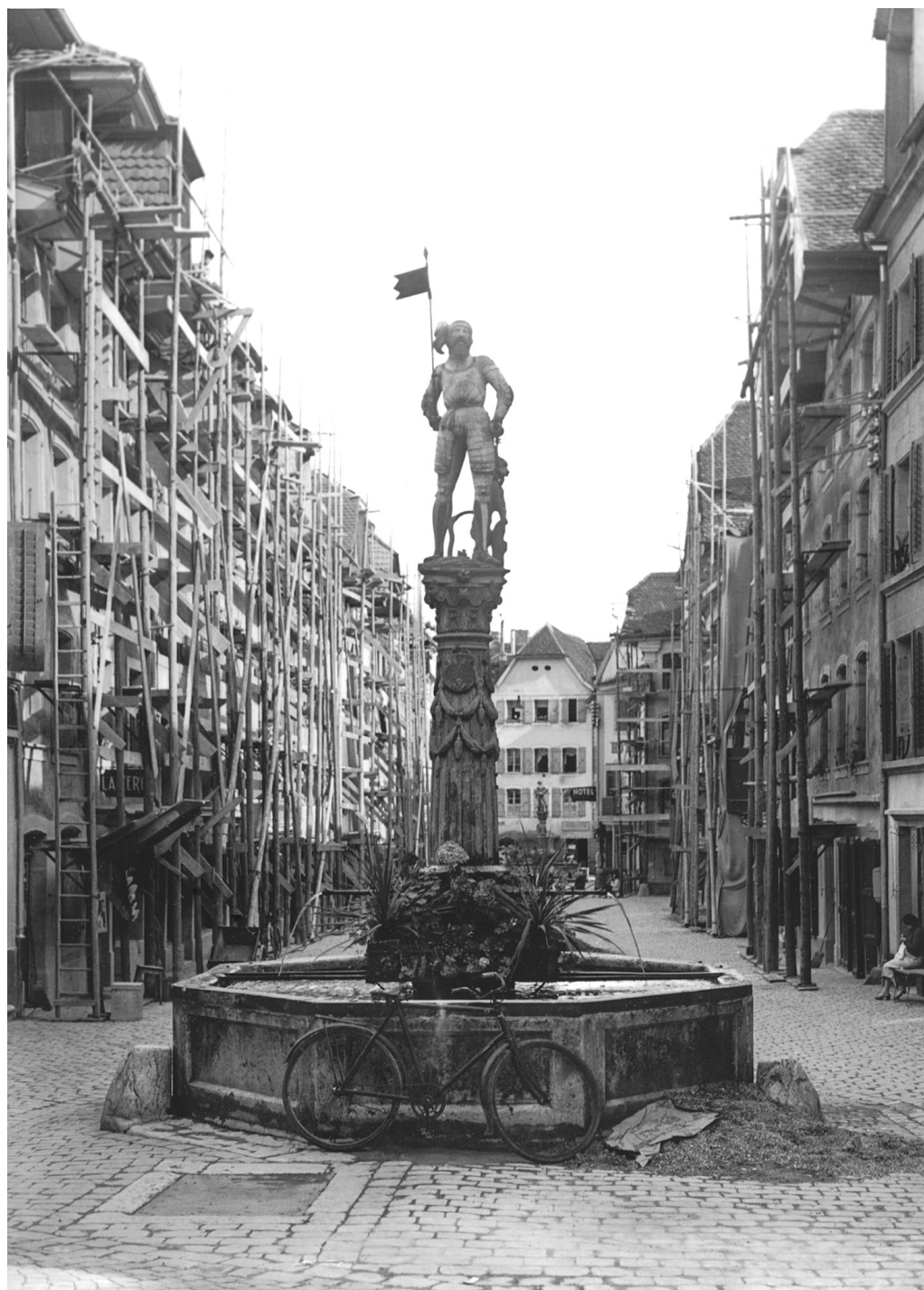
La Neuveville, 1936, Rénovation des façades de la rue du Marché (collection Charles Ballif)
